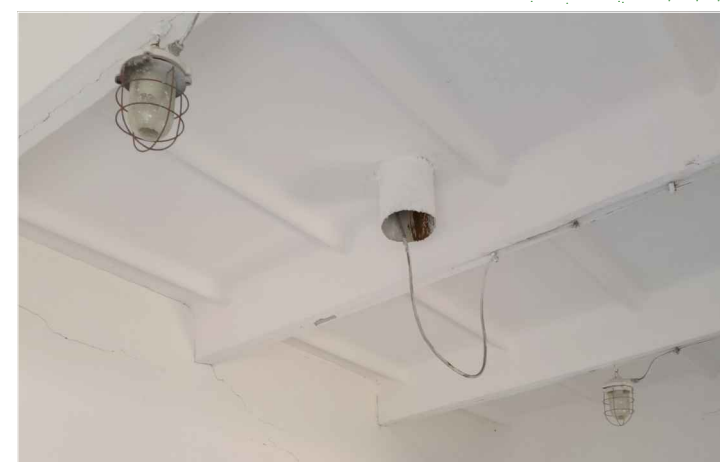
elementy instalacji elektrycznych w pom. 1/3
