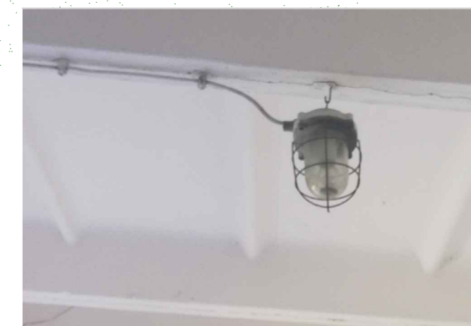
elementy instalacji elektrycznych w pom. 1/3
